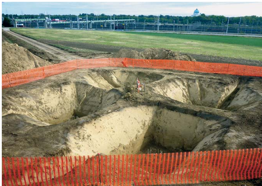
Abb. 2: Die Fundamentgruben des Strommasten M4, im Hintergrund die Kirche des Zentralfriedhofs. (Foto: M. Penz)
