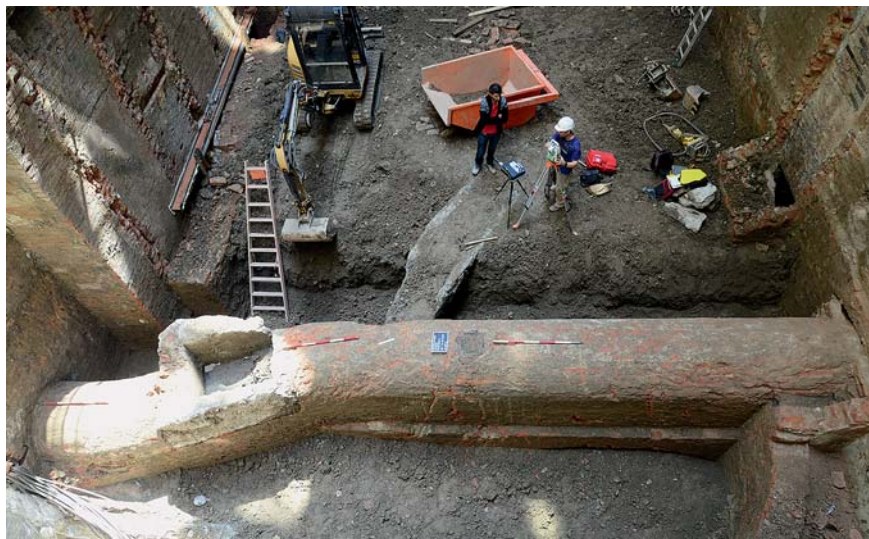
Abb. 4: Kanal mit modernem Seitenstrang und Fallrohreinmündung (Bef.-Nr. 1, 22–24), Blickrichtung Osten. (Foto: Stadtarchäologie Wien)
