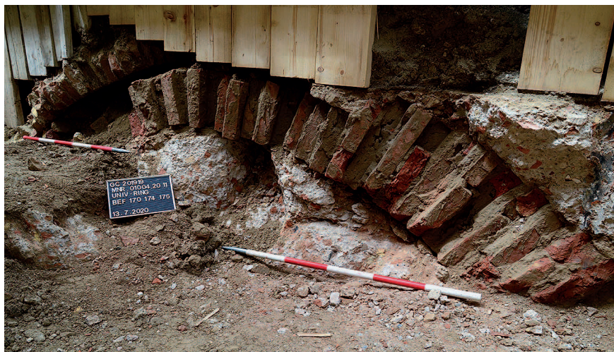
Abb. 5: Stark beschädigter Kern des Mauerwerks Bef.-Nr. 170 mit dem eingebetteten Ziegelbogen Bef.-Nr. 174 und dem späteren Ziegelbogen Bef.-Nr. 175 (oben), Blick von Nordosten. (Foto: Stadtarchäologie Wien)
