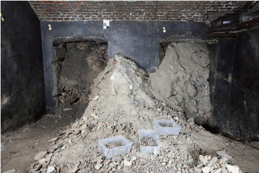
Abb. 2: Südmauer des Eiskellers mit den Nischen und Anschüttungen zu Beginn der Dokumentationsarbeiten. (Foto: L. Rastl)
