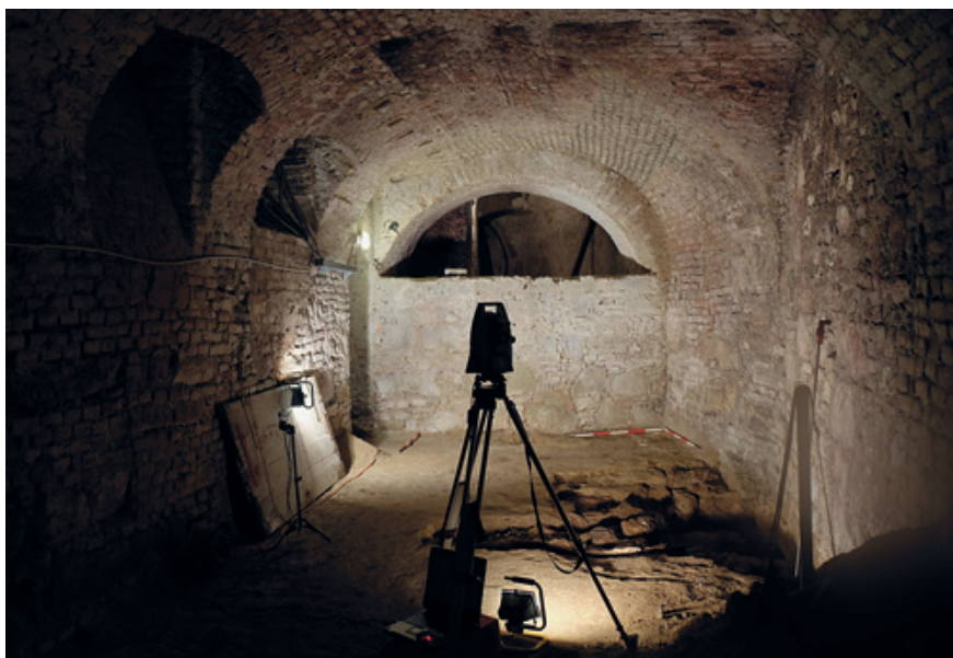
Abb. 2: Wien 1, Ledererhof 2. Kellerraum 1KG8 nach Südwesten. (Foto: C. Litschauer)
